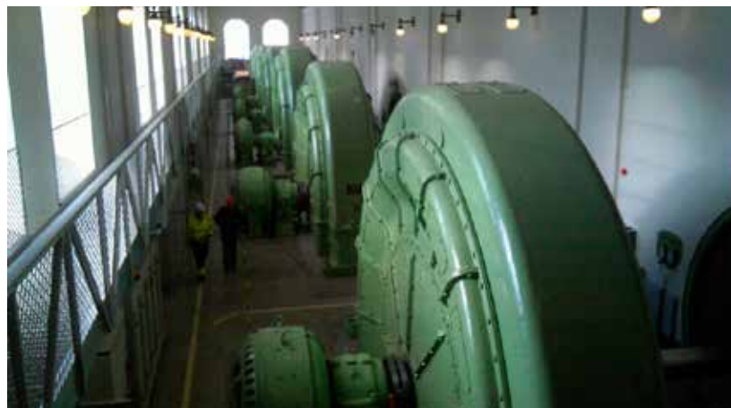
Figur 17 Rånåsfoss kraftverk med Francisturbiner før oppgradering (Foto: K. Bendiksen)
